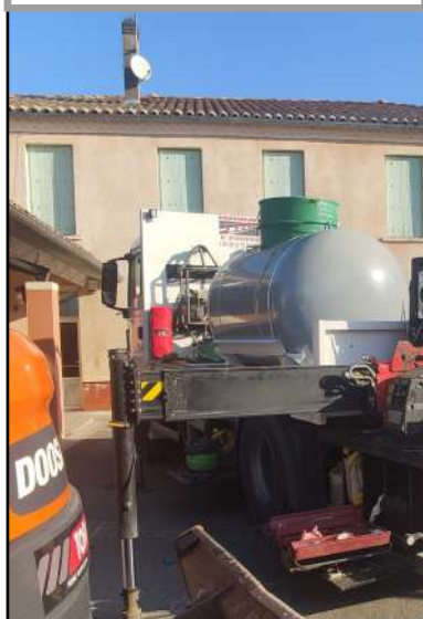
Nouvelle cuve ANTARGAZ
